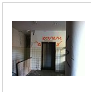
Fehlende Aufzugstüren im Küchengebäude
